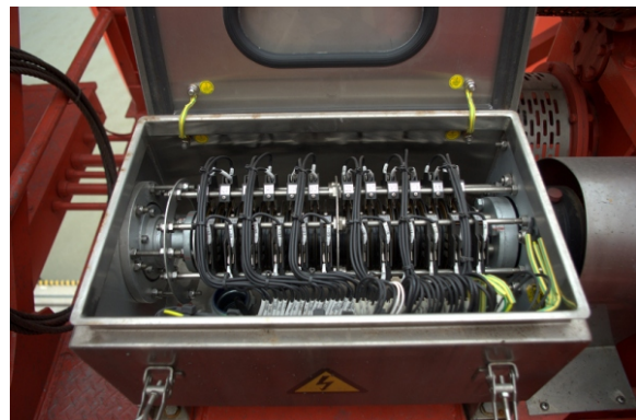
集电器内部 Inside of collector
